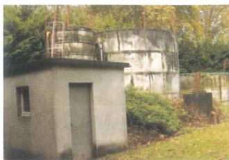
Station de traitement de Mollon
