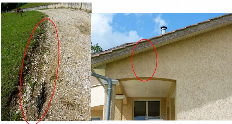
FIGURE 19 : SOURCE EN AMONT IMMÉDIAT DU GARAGE ET FISSURATION
