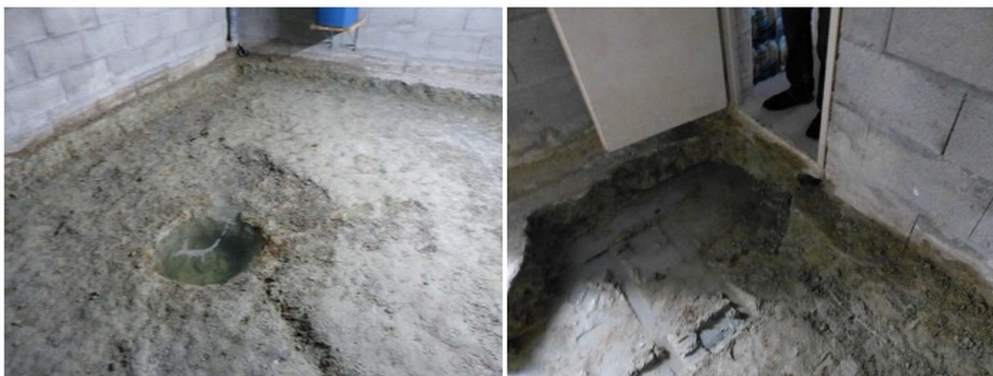
FIGURE 18 : PRÉSENCE D'EAUX AFFLEURANTES STAGNANTES EN FOND DE GARAGE
