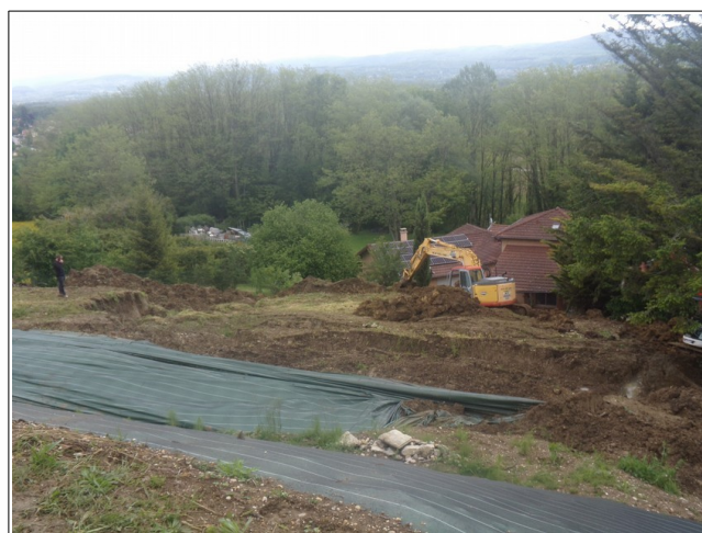
Figure II.11: glissement de terrain sur la commune de Villette-sur-Ain en aval du chemin de La Dombes (printemps 2021).
