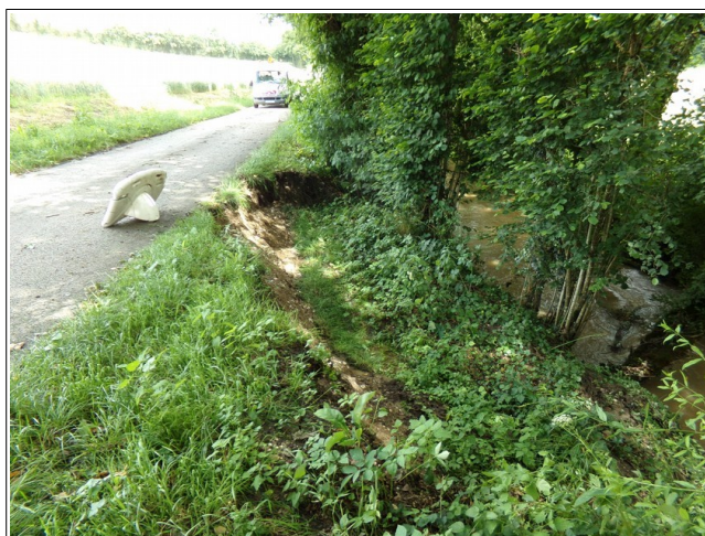
Figure III.66: affouillement du talus aval de la route de Mas-Joly par le ruisseau de la Toison.
