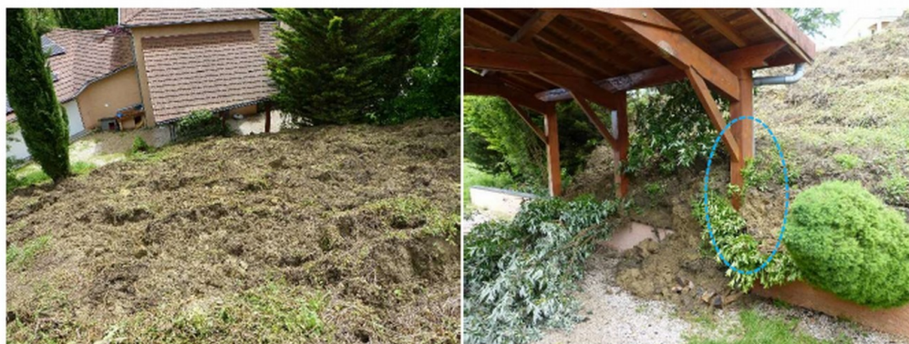
FIGURE 9 : VUE DU PIED DE GLISSEMENT (LANGUE PROPAGÉE DE MATÉRIAUX PLASTIQUES DESTRUCTURÉS) DEPUIS LE DESSUS ET DEPUIS L'AVAL
