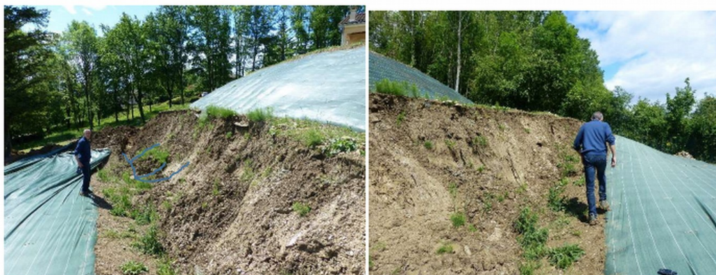
FIGURE 5 : TETE DU GLISSEMENT (SOURCES SUINTANT DANS LA PARTIE BASSE DE L'ESCARPEMENT)
