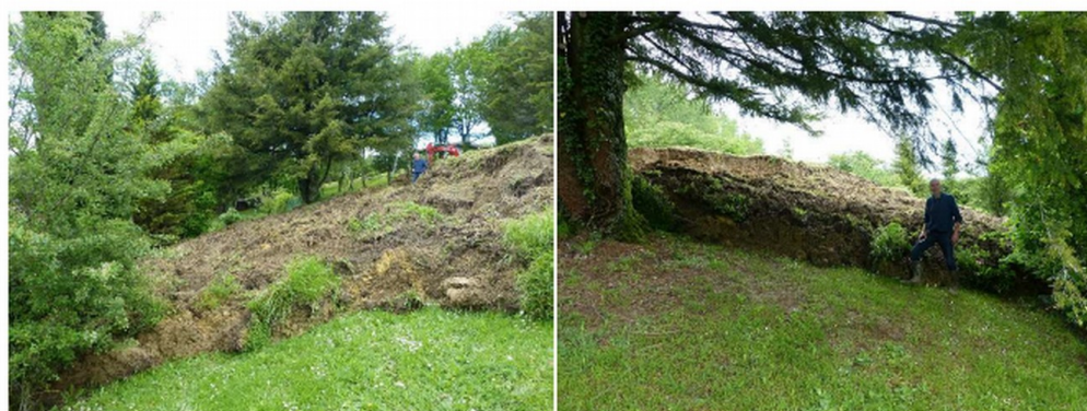
FIGURE 8 : LANGUE PLASTIQUE DE GLISSEMENT PROPAGÉ EN PIED DE GLISSEMENT SUR LE TALUS AVAL (UN PEU MOINS D'UN MÈTRE D'ÉPAISSEUR)
