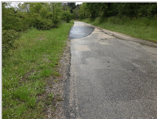
Figure III.39: zone instable de la route des Dombes nécessitant régulièrement un reprofilage de la chaussée.
