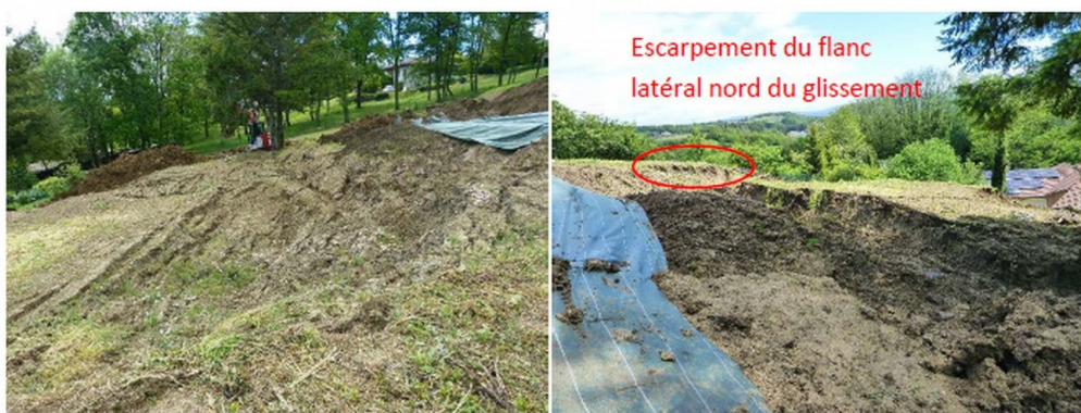
FIGURE 6 : PARTIE CENTRALE DU GLISSEMENT, VU DEPUIS LE NORD À GAUCHE ET DEPUIS LE SUD À DROITE
