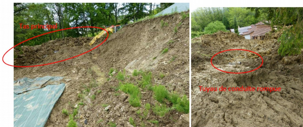
FIGURE 13 : ÉVACUATION DES EAUX EMERGENTES EN TÊTE DE GLISSEMENT BLOQUÉE PAR LE TAS PRINCIPAL ET DÉVIÉ SANS DOUTE DANS LE CORPS DE GLISSEMENT
