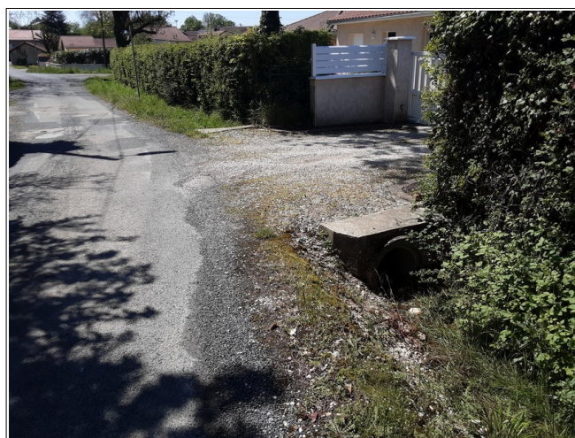
Figure II.9: point bas inondable dans le hameau de Turgon (commune de Drullat) situé en continuité d'un axe de ruissellement;
