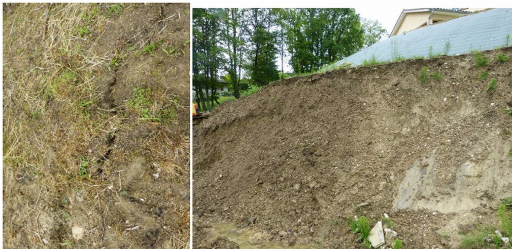
FIGURE 16 : CREVASSE EN ARRIÈRE DU FRONT LATÉRAL NORD ET ACCENTUATION DE L'ESCARPEMENT DE TÊTE
