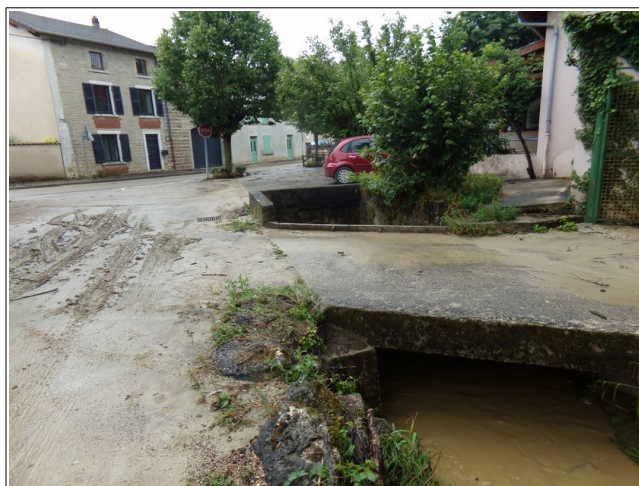
Figure III.44: débordement du ruisseau de Copan le 30 juin 2021 sur la RD984 et dans le hameau de Bublanne.
