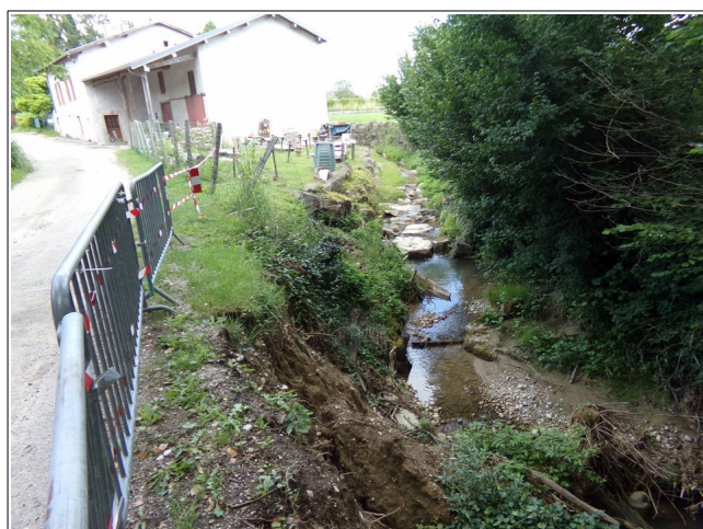
Figure II.1: érosion de berge le long du ruisseau du Gardon dans le hameau de Mollon (commune de Villieu-Loyes-Mollon)
