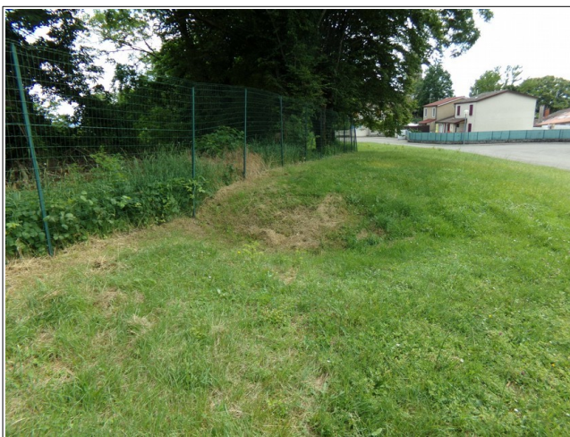
Figure III.77: secteur impacté par le glissement de terrain de 1983. On distingue au premier plan une irrégularité à la surface du terrain qui a pu être formée par le phénomène. Huit maisons ont dû être démolies sur cet emplacement.
