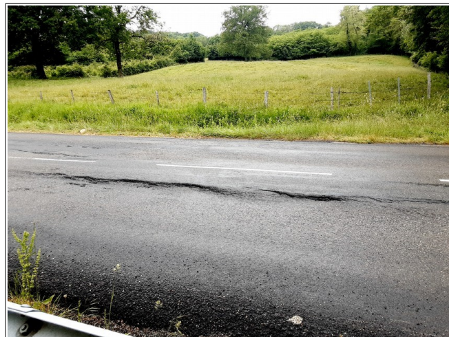
Figure III.24: pied du versant de la Grange ; terrains et RD 984 déformés.
