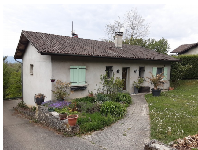
Figure III.55: maison de la rue Rousset sous laquelle s'est propagé un glissement de terrain.
