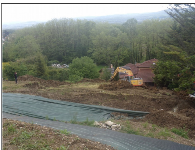
Figure III.37: vue générale vers l'aval du glissement de terrain de la parcelle 403 et de la maison menacée à l'aval.
